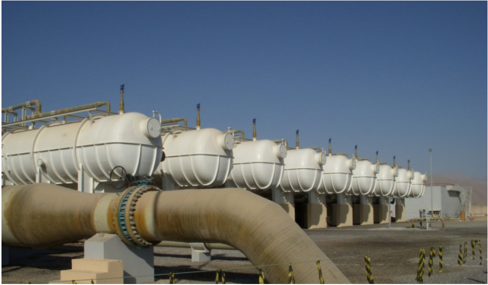
Fig. 24. Single media Pressure filters (Oman Sur desalination Plant)
